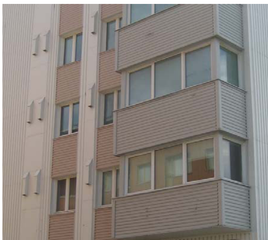
Figur 8. Exempel på hur ljuddämpning av befintlig friskluftsventil kan arrangeras. På fotot visas hur ljuddämpningen har placerats utvändigt på fasad som avlånga "lådor". Metoden användes bland annat i Malmö längs kontinentalbanan i Svedabs åtgärdsprogram i slutet på 1990-talet.
