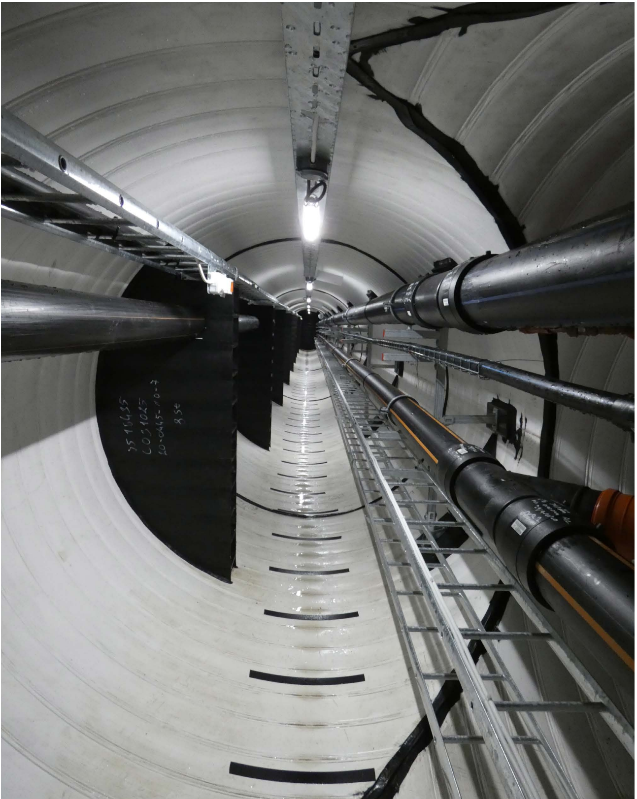
I Södra Häggvik planerar SEOM en infrastruktur-kulvert istället för konventionell ledningsläggning. Metoden kan ge både effektivare byggnation och drift samt ger möjlighet till trädplantering ovanför kulverten.
