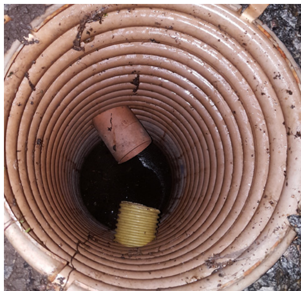
Tillsynsbrunn med sandfång i botten.
